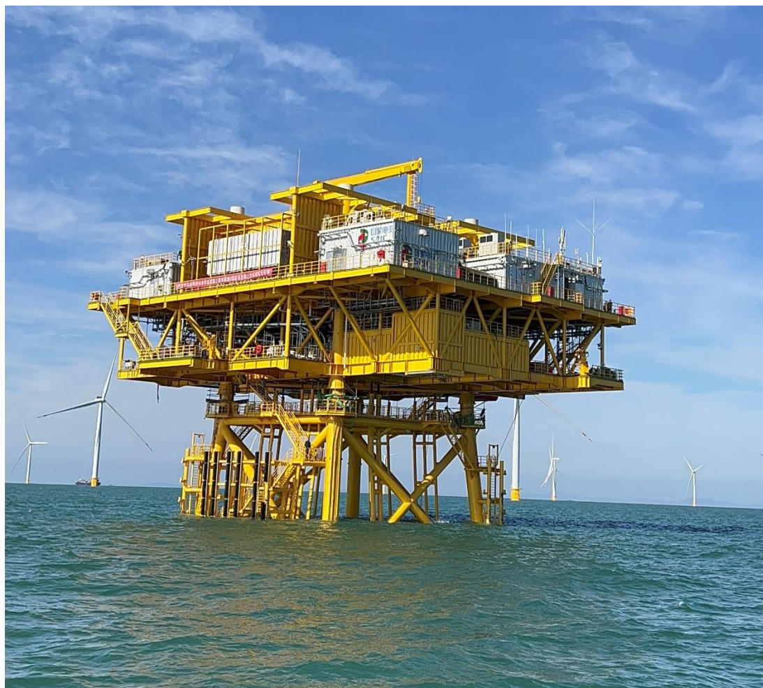
图 2.2-8 海上升压站现状图
