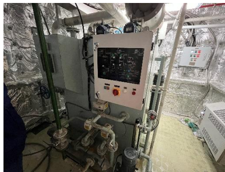
海上升压站生活污水处理装置
