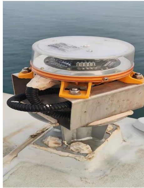
海上风机顶端照明设施
