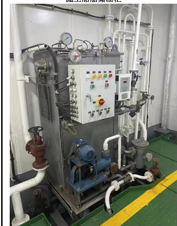
施工船舶油水分离器铅封
