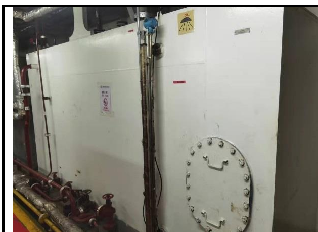
施工船舶储油柜
