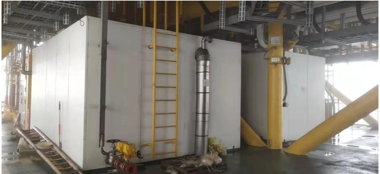
图 2.2-9 海上升压站事故油罐
